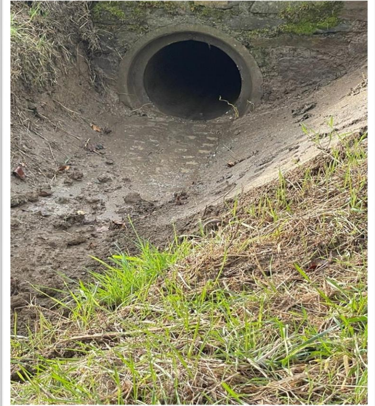
Verrohrung nach der Hochdruckreinigung
