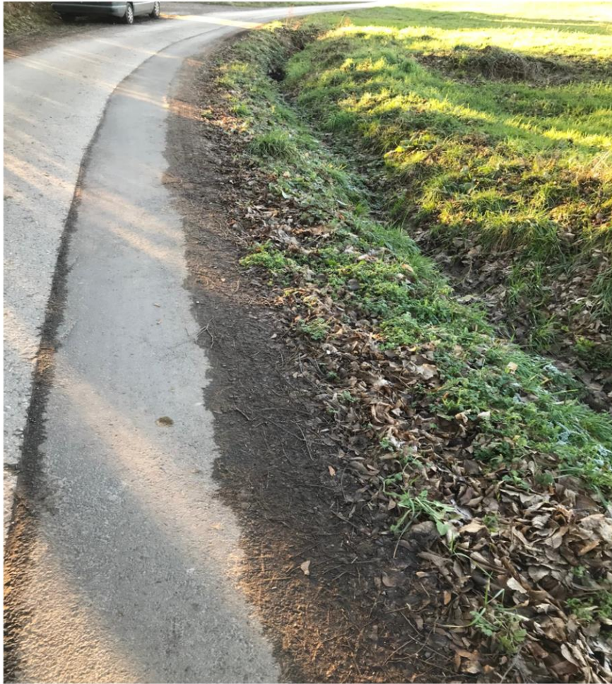
Sickergraben in der Gemarkung Lohrsdorf vor der Reinigung.
