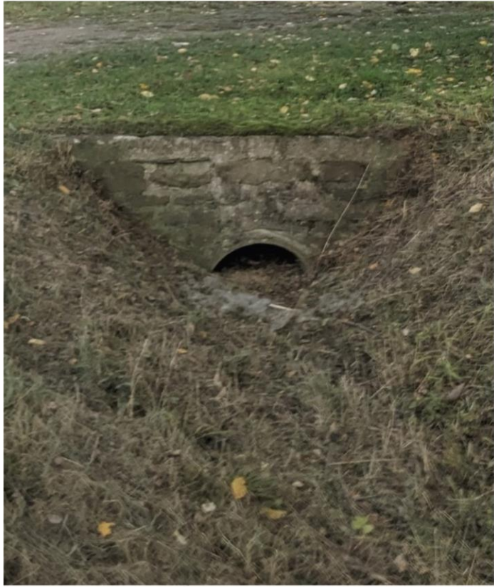
Verrohrung in einem Sickergraben in der Gemarkung Bad Neuenahr
